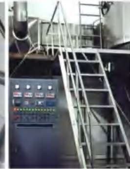
控制系统 Control System
